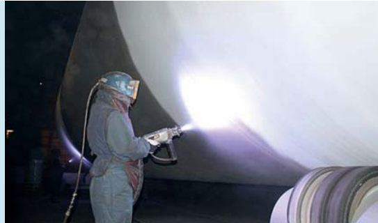
Bild 4: Beschichten eines Turmsegments durch Lichtbogenspritzen (Werkstoff ZnAl) Fig. 4: Coating a tower segment using arc spraying (spray material ZnAl)
